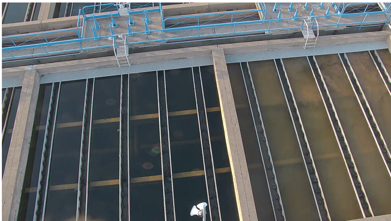
FIGURA 1. Ejemplos de decantadores en estado normal (izquierda) y roto (derecha)
