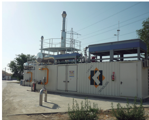
Detalle de los motogeneradores planta de Las Dehesas clasificación
