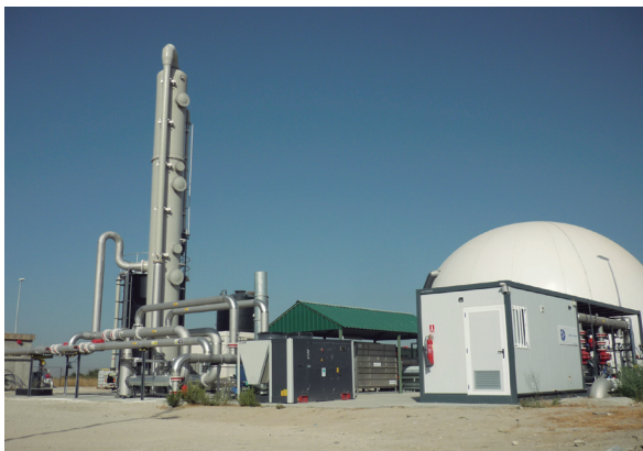
Estación depuradora del biogás del vertedero de Las Dehesas
