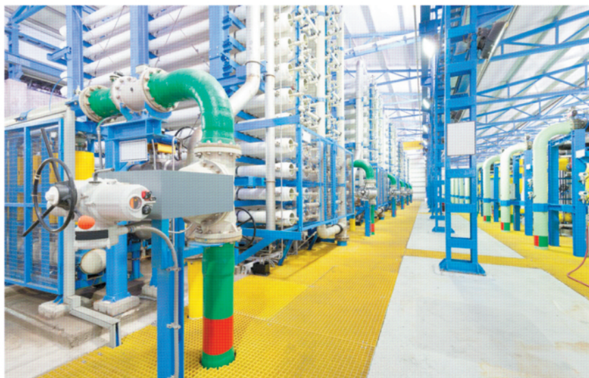
Fotografía del interior de los bastidores de ósmosis inversa de una planta desaladora.
